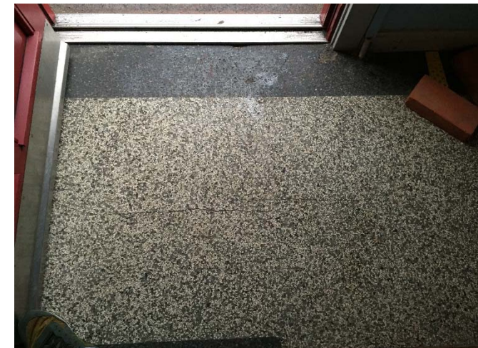
Terrazzobelægningen er revnet i flere opgange, hvilket er et tegn på, at der er begyndende tæring af de underliggende bæreejere.
