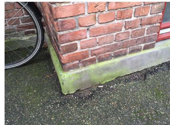
Sokkel fremstår med afskalninger og revner.
