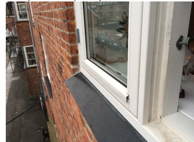
Det bemærkes, at sålbænke er placeret uhensigtsmæssigt ift. afvanding fra vinduerne.
