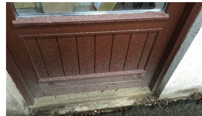
Døre til kælder fremstår med nedbrudte bundtrin.
