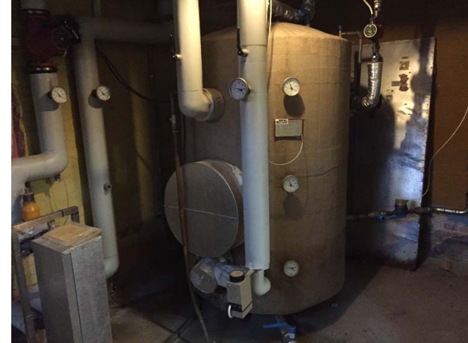
Varmtvandsbeholder og rørføring er isoleret.
