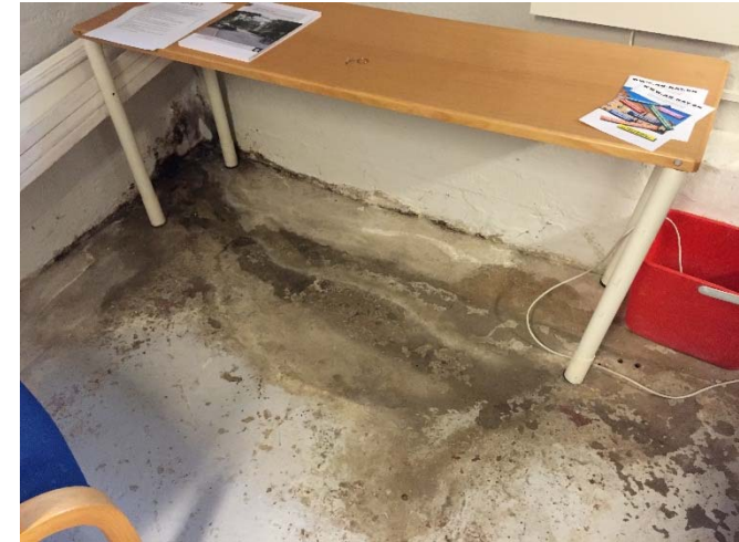
I bestyrelseslokalet ses der problemer med fugtindtrængning.
