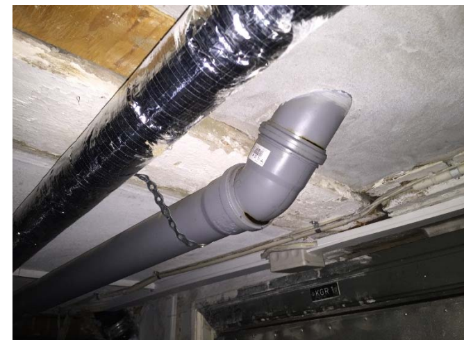
Plastafløb, som er ført gennem etagedæk udgør en forringelse af brandmodstandsevnen for bygningsdelen og bør udskiftes til ubrandbart materiale.
