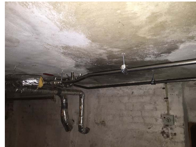
Vandinstallationer er udført i rustfrit stål. Der ses flere strækninger med manglende isolering.
