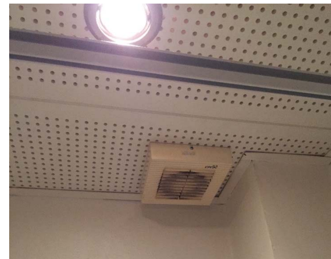
Naturlig aftrækskanal med påmonteret ventilator.
